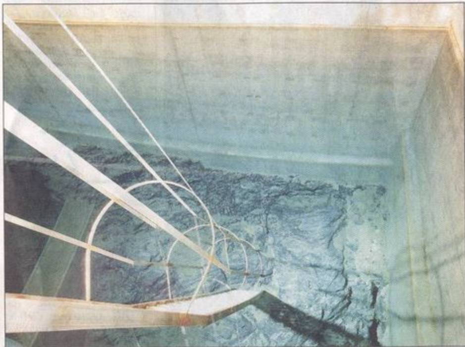
Ein Blick in die Warsteiner Hillenberg-Quelle.
